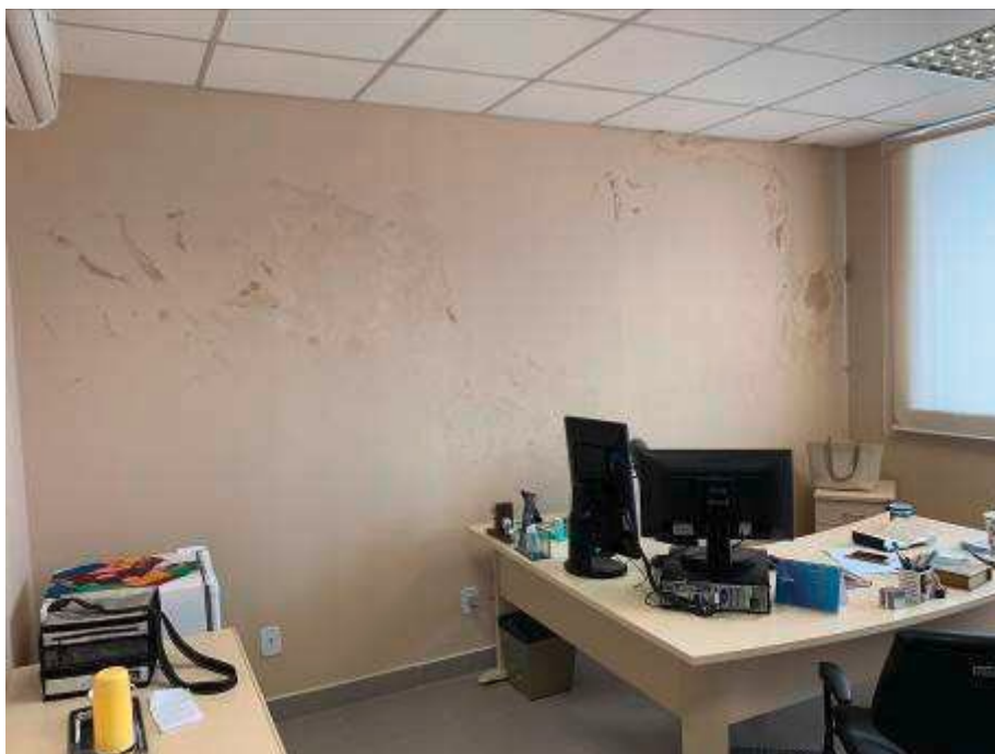
Infiltrações Gabinete Juíza Titular 1ª Vara
