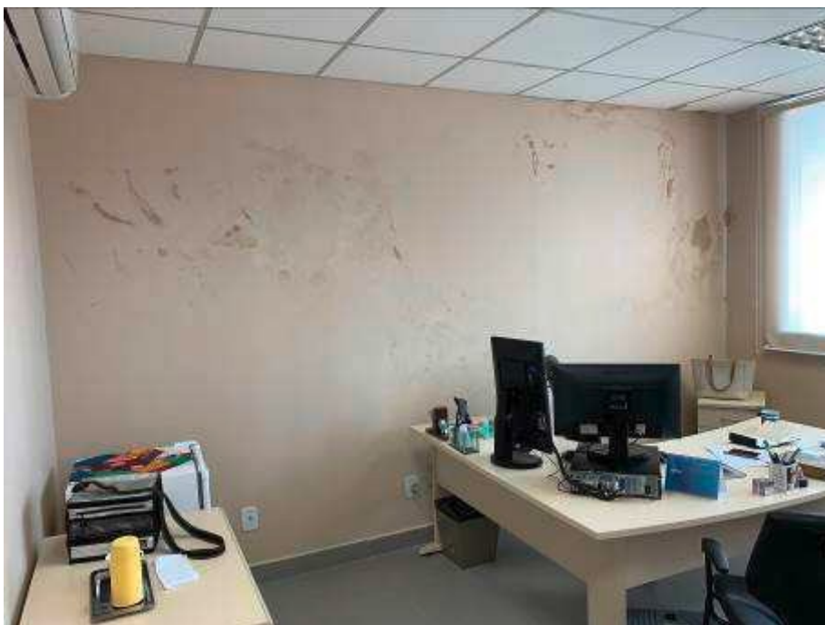
Infiltrações Gabinete Juíza Titular 1ª Vara
