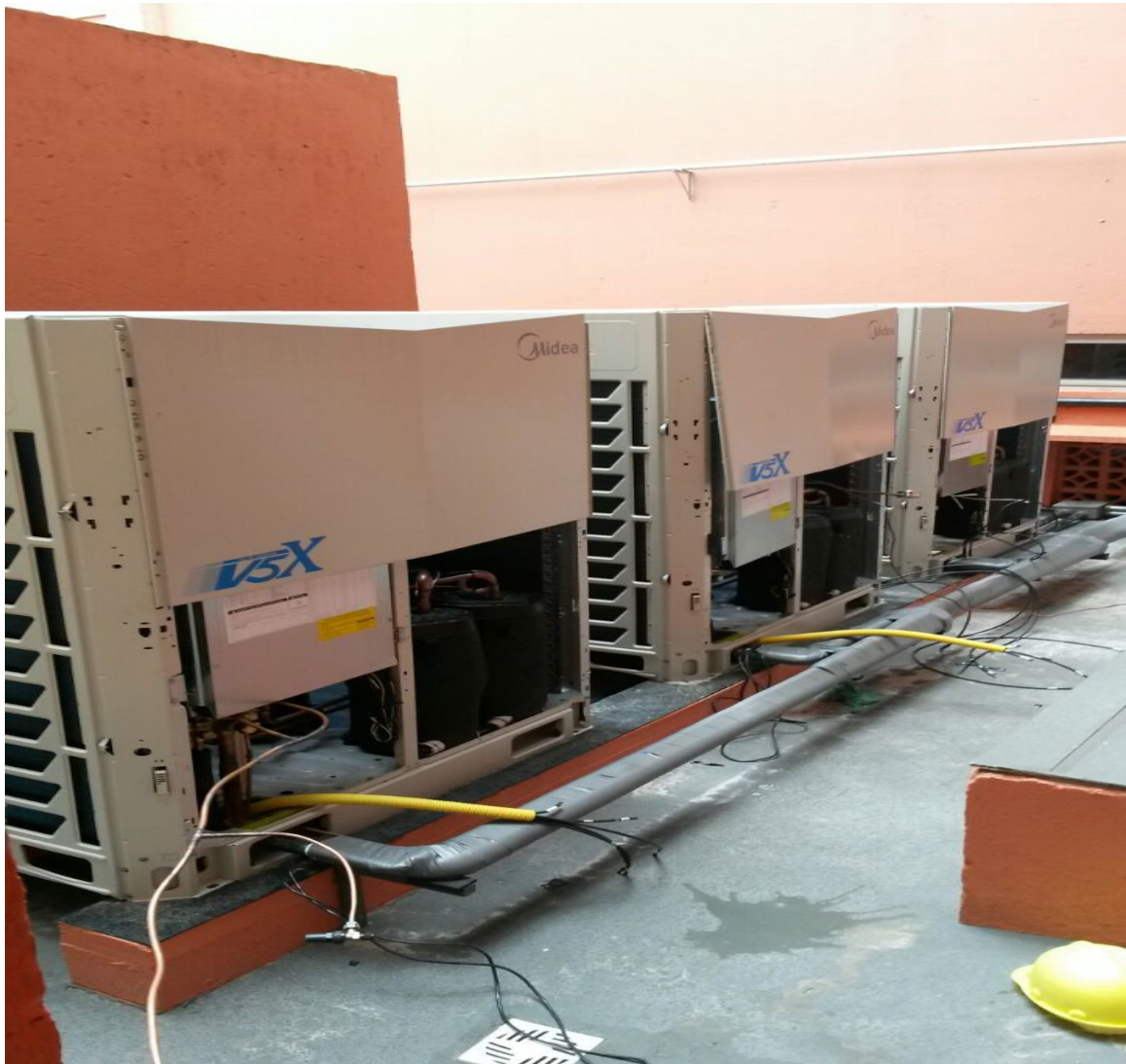
Sistemas ar condicionado VRF (máquinas)
